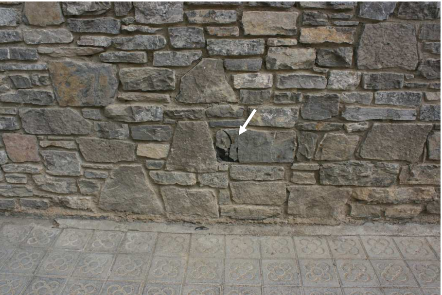
Fotografia 3: Detall d'un impacte a la paret de l'edifici del número 32 (fletxa blanca).
