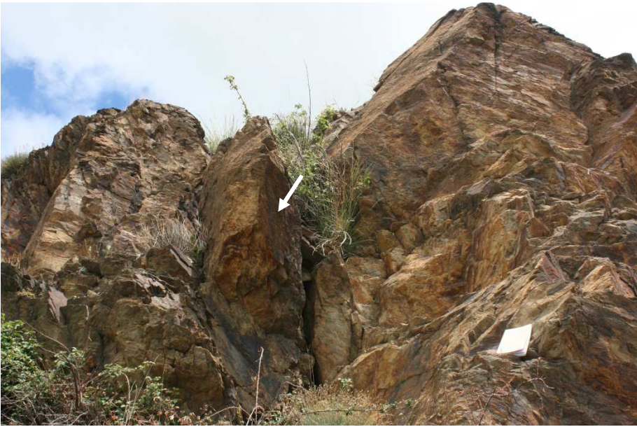
Fotografia 18: Vista de detall d'un bloc individualitzat susceptible de desprendre's, a la vertical del número 39.
