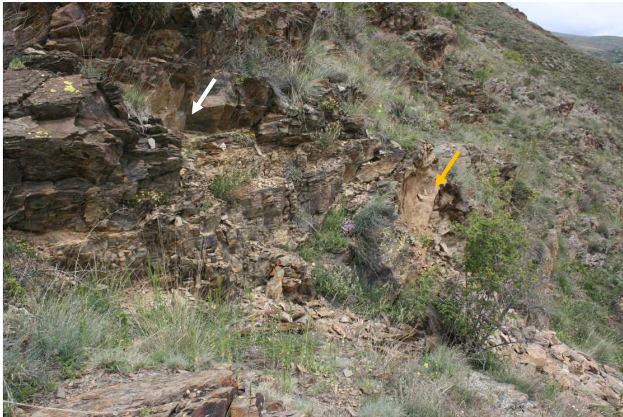
Fotografia 7: Vista de la zona on es va fer la purga per part dels bombers (fletxa blanca) i la zona de sortida del despreniment (fletxa taronja).
