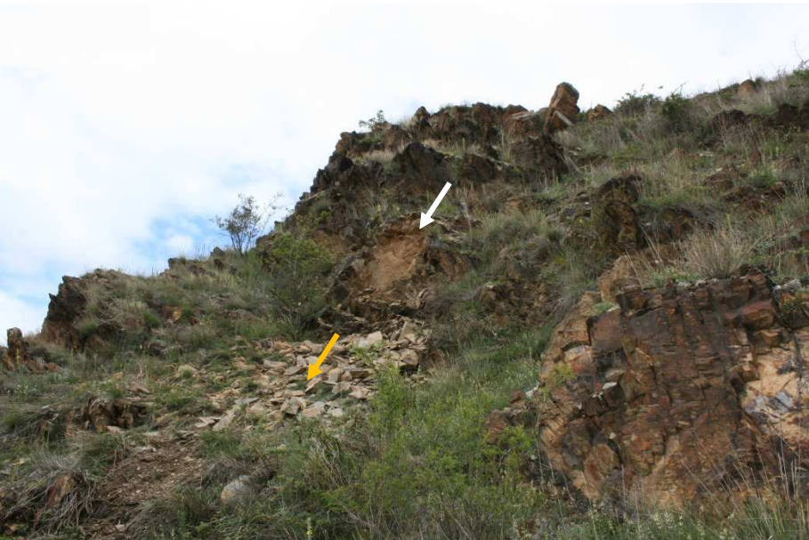
Fotografia 5: Zona de sortida del despreniment del 26 de maig, on s'observa la cicatriu (fletxa blanca) i restes de fragments del despreniment (fletxa taronja).
